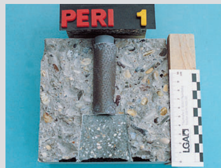
Nepropustný prostup je vždy nejlevnější!
